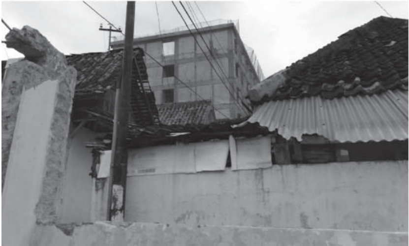
Gambar 4.3 Rumah kedua yang sudah rata dengan tanah, lokasinya berada tidak jauh dari hotel yang baru dibangun, Kampung Sayidan, Sumber: Dok. Penulis
