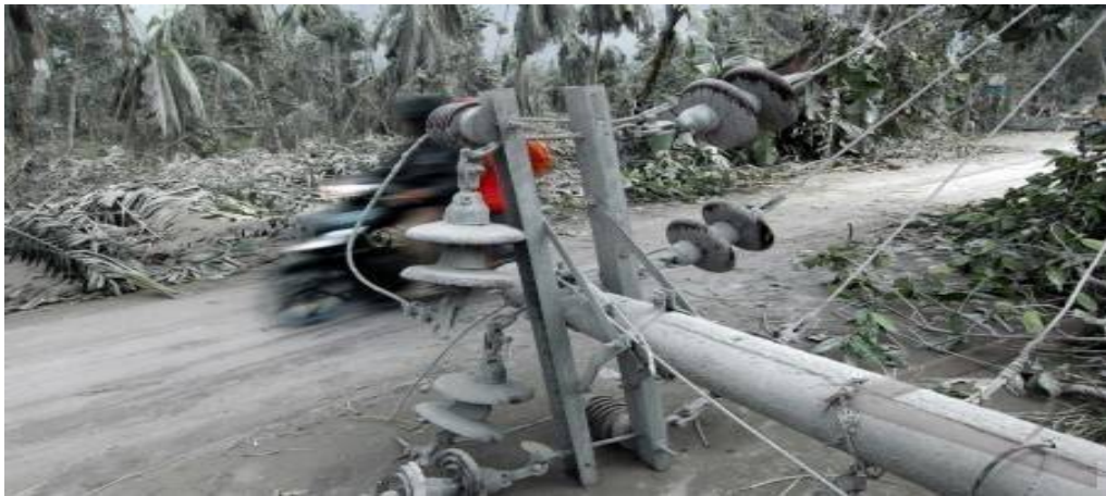
Gambar 22. Prasarana Listrik yang Roboh
